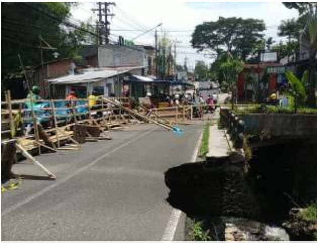
Kondisi jembatan Sonokembang, Kelurahan Pandanwangi, Kecamatan Blimbing, Kota Malang. (Santi/Lentera)
